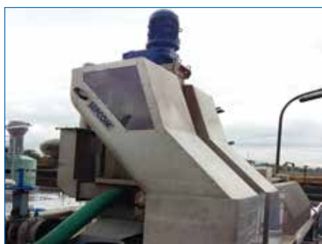
Čištění odpadních vod (SEPCOM Industrial Vertikální)
